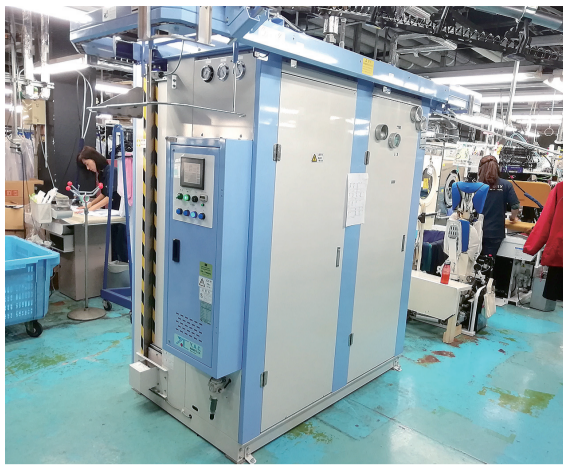
工場に導入したトンネルボックスフィニッシャー「YTB-180」
